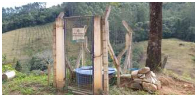
Figura 16: Caixa de Quebra de Pressão nº 1
