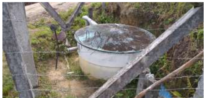
Figura 26: Caixa de Quebra de Pressão nº 3.
