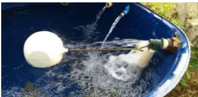
Figura 17: Caixa de Quebra de Pressão nº 1.
