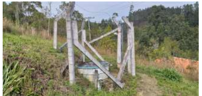
Figura 24: Caixa de Quebra de Pressão nº 3.
