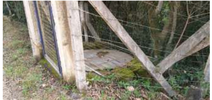
Figura 22: Caixa de Quebra de Pressão nº 2.
