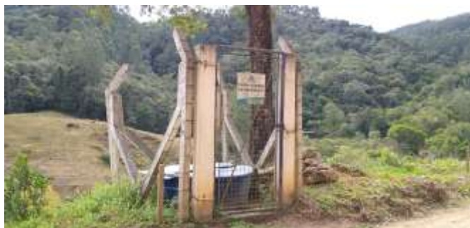
Figura 15: Caixa de Quebra de Pressão nº 1
