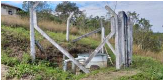
Figura 23: Caixa de Quebra de Pressão nº 3.
