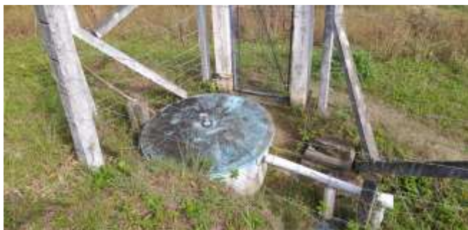
Figura 25: Caixa de Quebra de Pressão nº 3.
