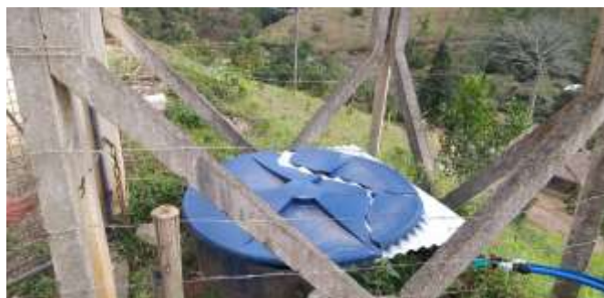
Figura 18: - Caixa de Quebra de Pressão nº 1.
